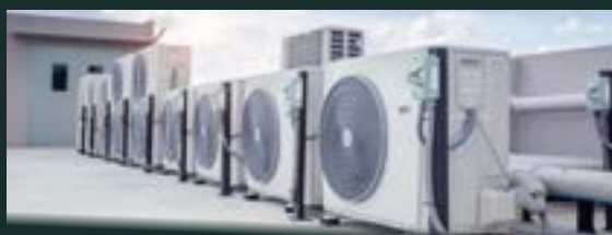
Bomba de calor
